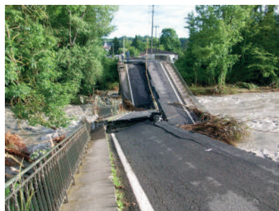
Le pont de Saint-Laurent-de-Neste détruit par la crue de juin 2013
